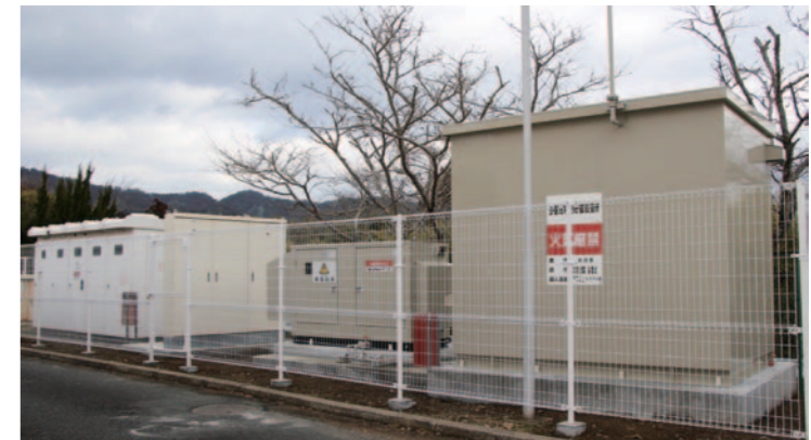
非常用発電機及び燃料タンク(めぐみの里)
